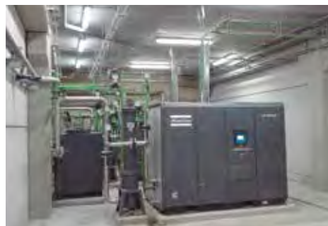
Vista de la nueva sala de aire comprimido.
