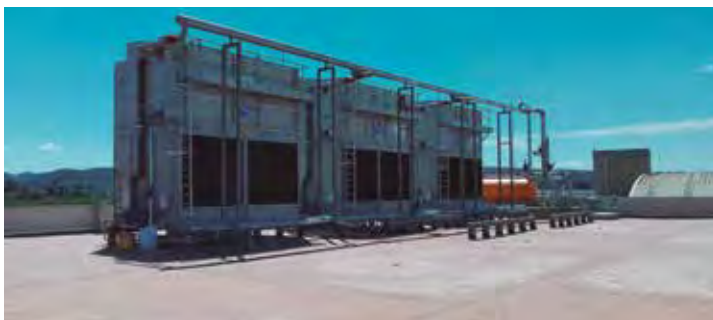
Vista de los nuevos condensadores evaporativos.
